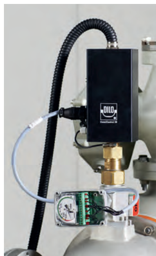
Caja de conexión para la verificación del densímetro en estado instalado
